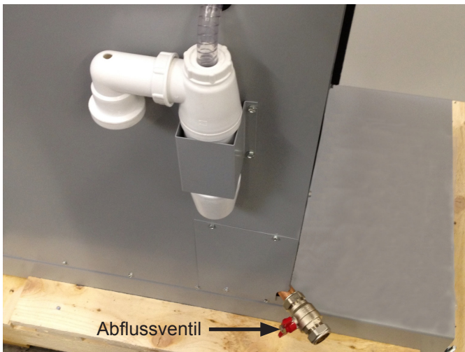
Entleerungshahn und Wartungsabsperrentil
